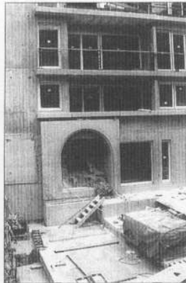
Vue du même segment d'aqueduc Médecis intégré aux immeubles, un an plus tard, avril 2002.
