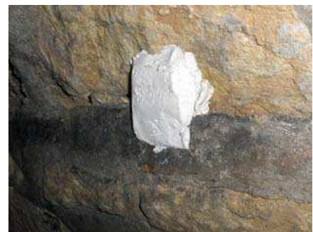
Témoin encore en place sur une fissure !
