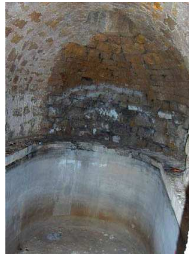
Réservoir d'eau pour la fontaine (photo: Légionnaire)
